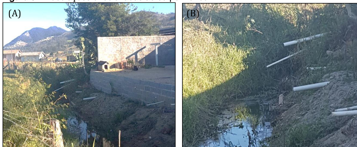
Figura 3 – Tubulações direcionadas ao corpo hídrico
