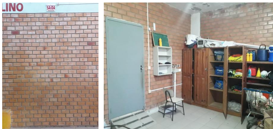
Figura 4 – Placa de sinalização para abandono do local (a) localizada próximo ao sanitário masculino e (b) sala de materiais esportivos.
