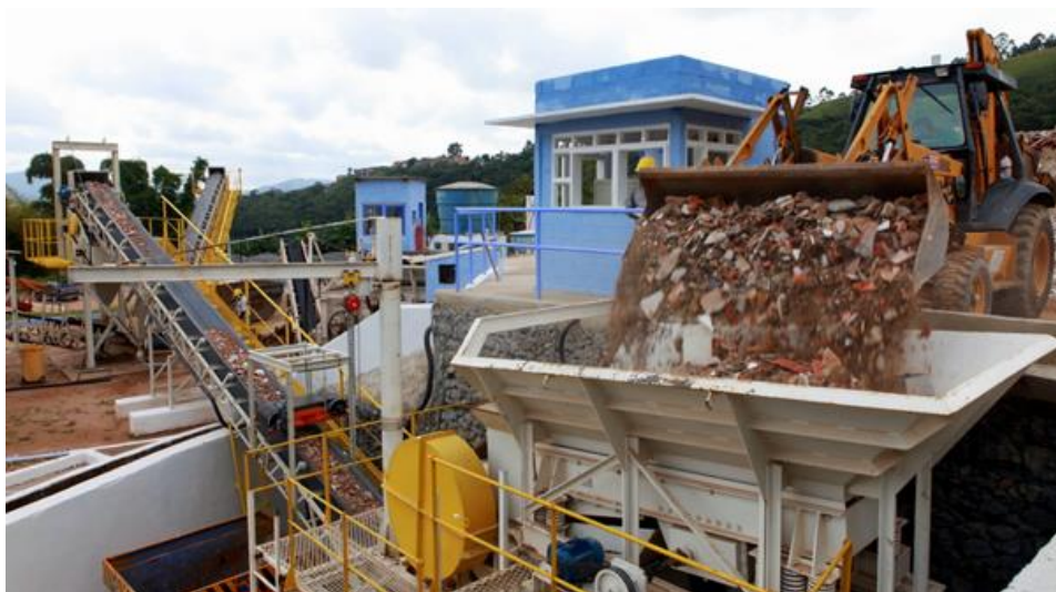
Figura 02 – Usina de beneficiamento
