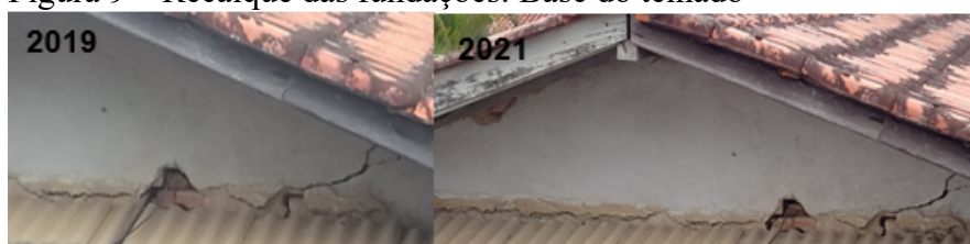
Figura 9 – Recalque das fundações: Base do telhado
