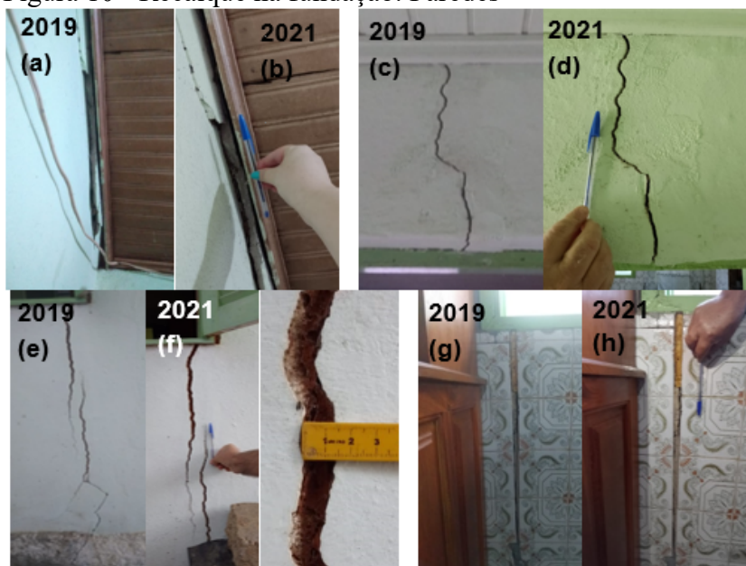
Figura 10 - Recalque na fundação: Paredes
