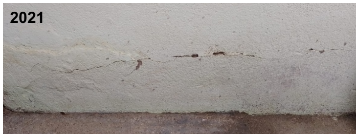
Figura 13 – Trincas por variação do teor de umidade na fachada externa da cozinha
