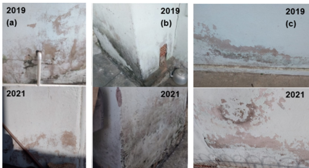
Figura 14 - Manchas de umidade e pulverulência
