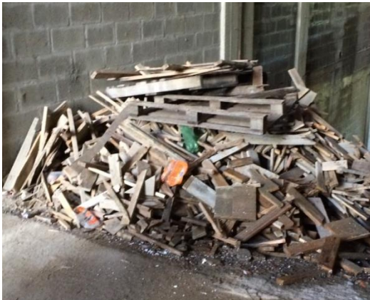
Figura 5 - Resíduos classe B no canteiro da obra 3.
