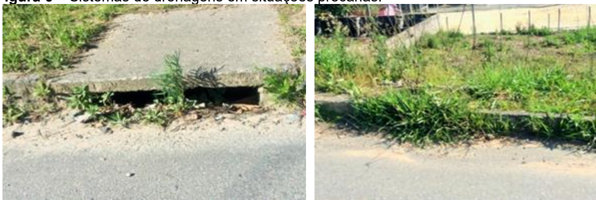
Figura 6 – Sistemas de drenagens em situações precárias.
