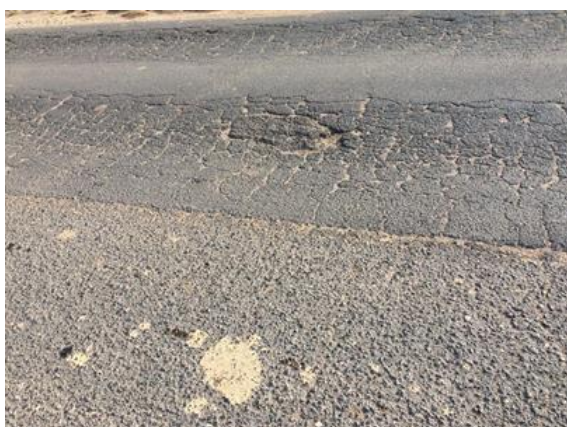
Figura 08 - Desgaste com trincas do tipo jacaré
