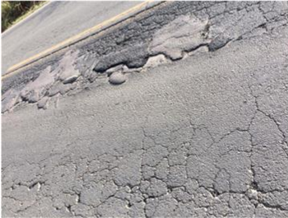
Figura 5 - Remendo com trincas interligadas tipo jacaré.
