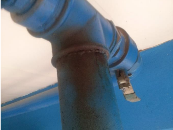
Figura 1 – Vazamento rede de ar comprimido (região escura).
