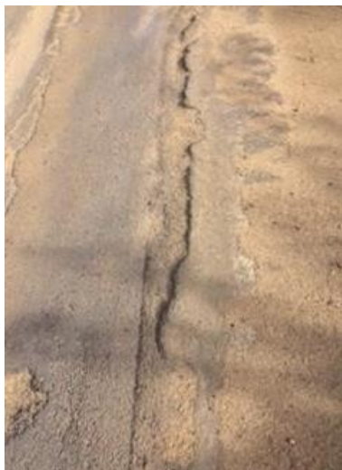
Figura 7 - Escorregamento de massa
