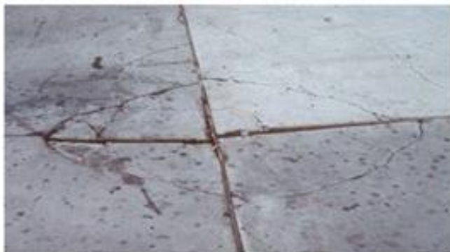
Figura 6 - Empenamento de placa de concreto
