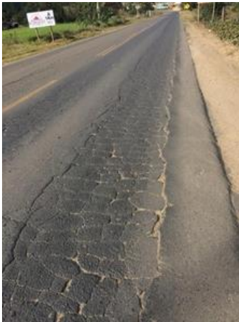
Figura 6 - Afundamento de trilha de roda, com trincas de bloco.
