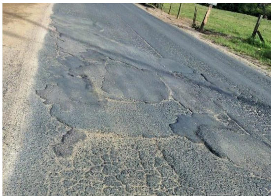
Figura 4 - Remendo mal executado
