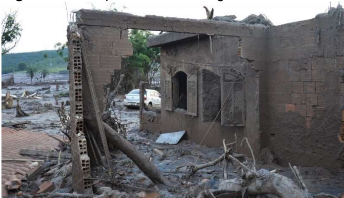
Figura 1 – Rompimento da Barragem Samarco dizimou a região de Bento Rodrigues
