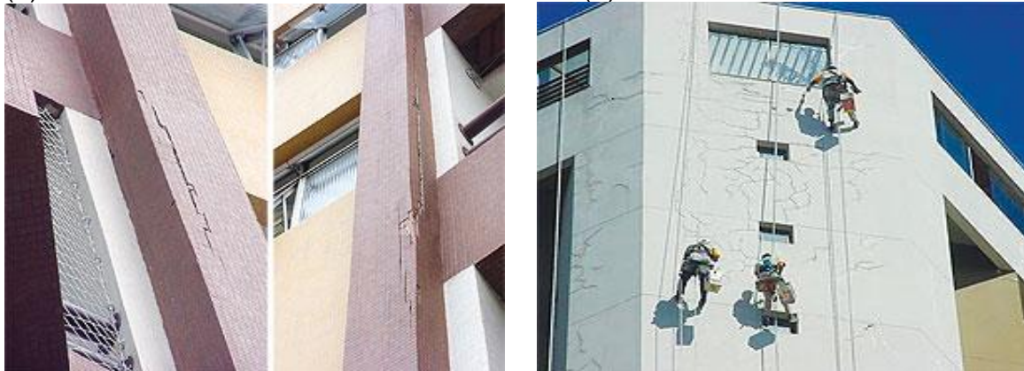
Figura 1 – Fissuras por corrosão de armadura (a); e por retração da argamassa (b). (a) (b)
