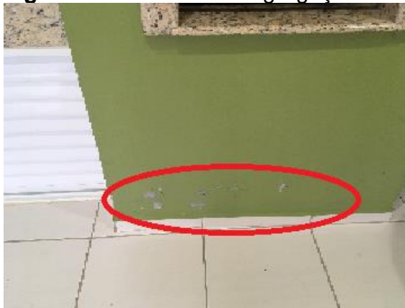
Figura 8 – Bolhas e desagregação.
