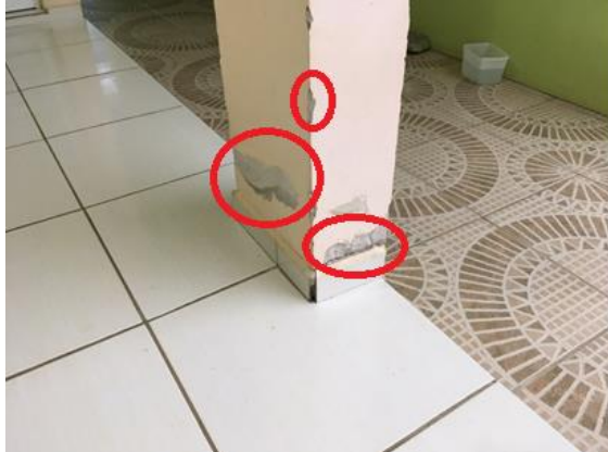
Figura 9 – Descascamento e desagregação.
