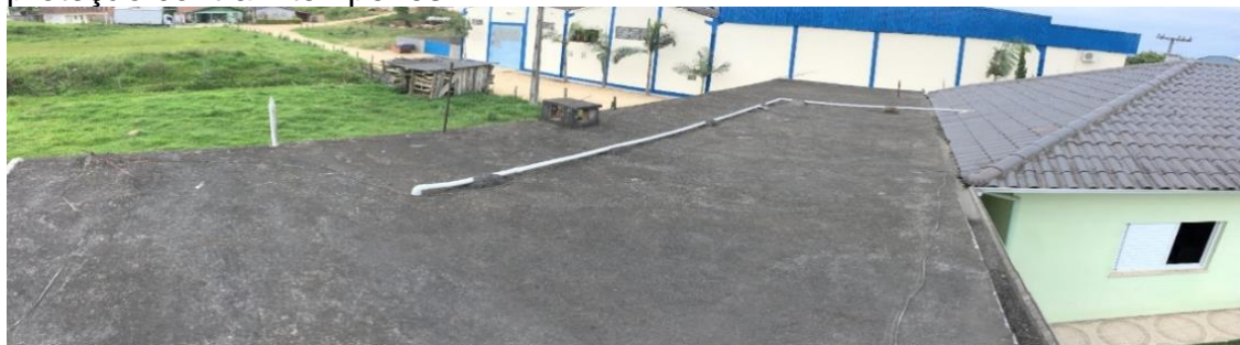
Figura 11 – Vista superior da parte da edificação (laje) sem impermeabilização ou proteção contra intempéries.
