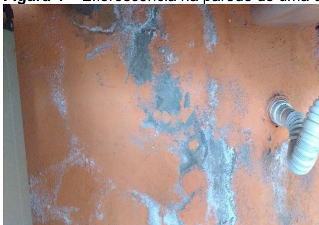
Figura 4 – Eflorescência na parede de uma edificação.
