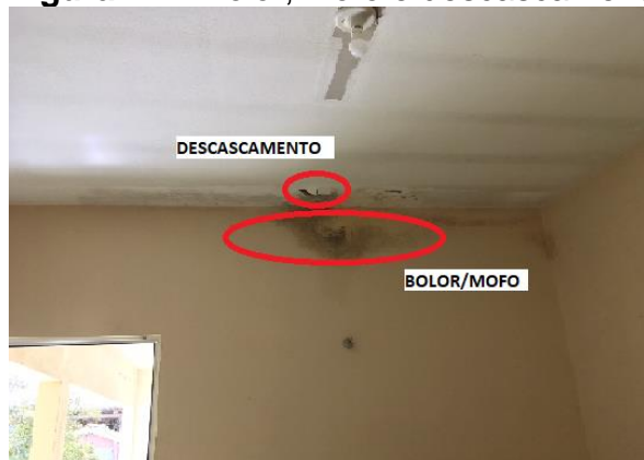
Figura 12 – Bolor, mofo e descascamento.
