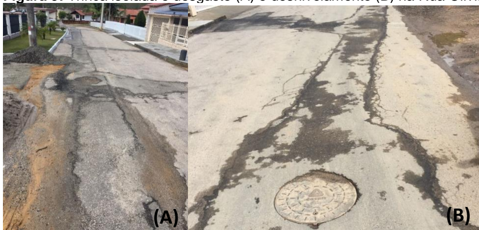
Figura 9: Trinca isolada e desgaste (A) e desnivelamento (B) na Rua Olivia N. Rita.
