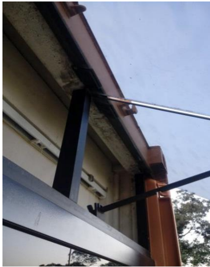
Figura 08 – Parte externa oxidada
