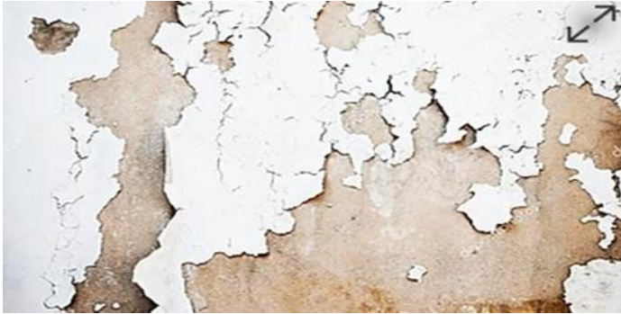
Figura 9 – Descolamento de pintura em parede de alvenaria.
