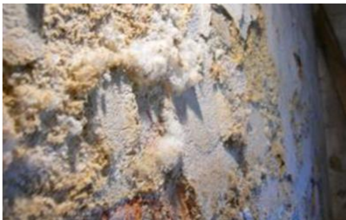
Figura 8 – Eflorescência na parede de uma edificação.
