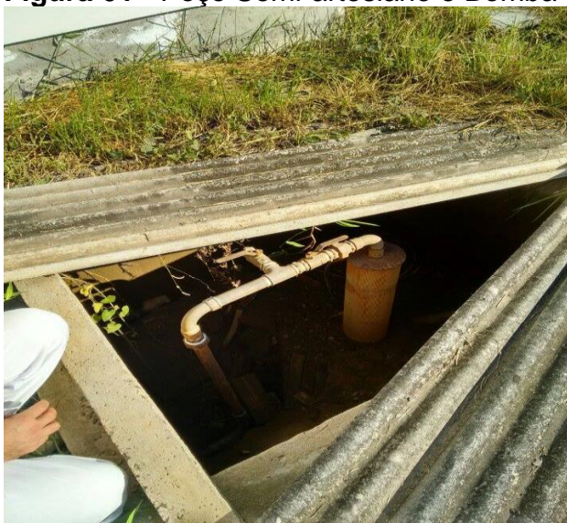
Figura 01 - Poço Semi-artesiano e Bomba
