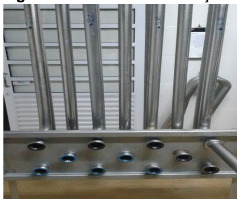
Figura 8 - Painel de Distribuição
